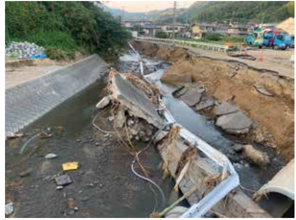
◎清水区草薙 草薙川の堤防が一部破損され危険な状態となった
