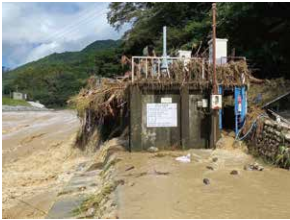
◎清水区承元寺 取水口が流木で機能停止 清水区63,000戸が断水
